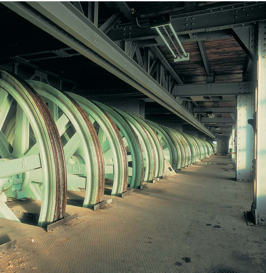
Die südliche Seilscheibenreihe im obersten Stockwerk des Hebewerkes
